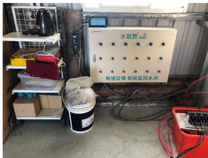
智能電箱可以串聯節能水車、監視系統與投餌/投料機
